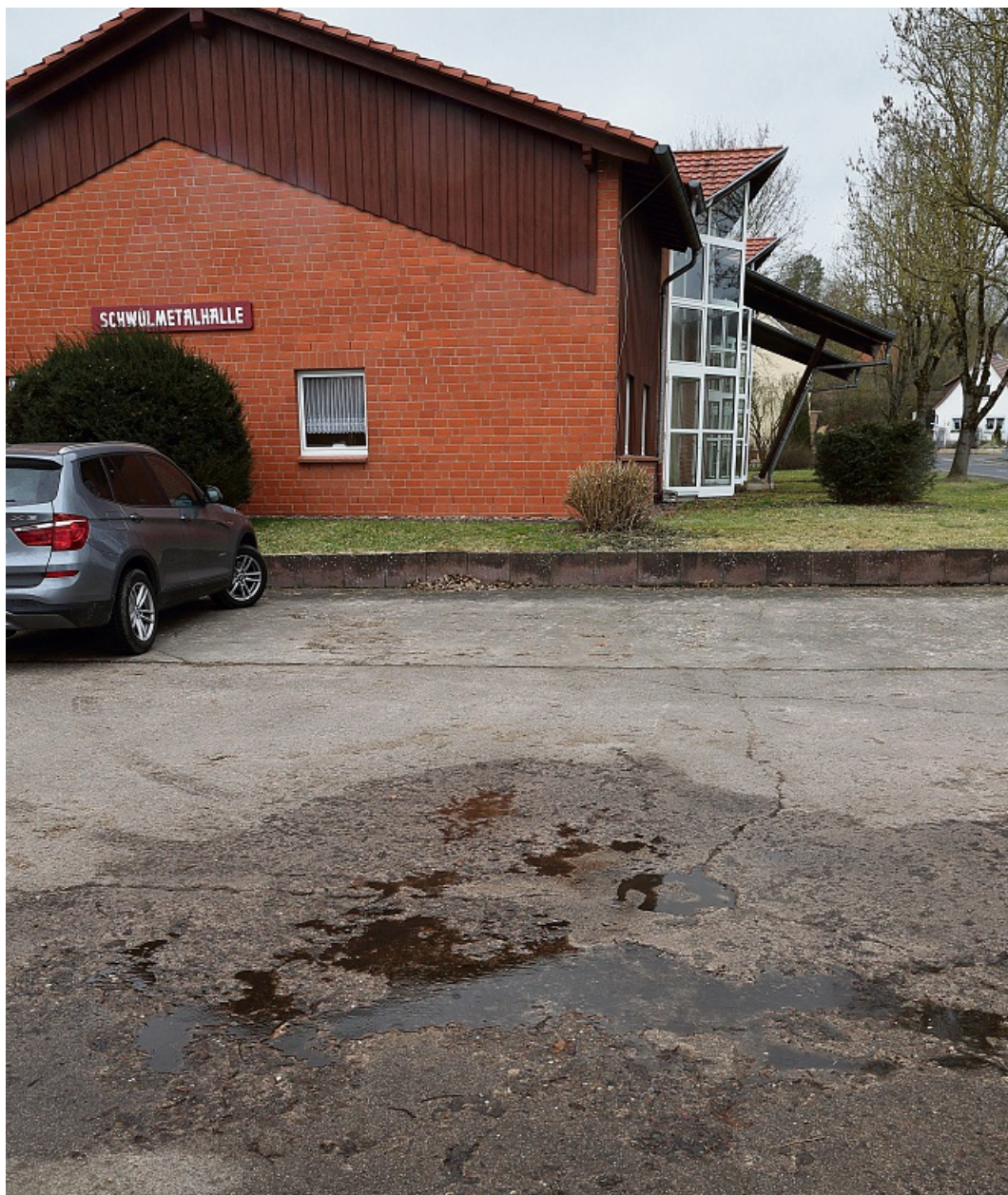
Soll asphaltiert werden: Teilweise besteht der Platz vor der Schwülmetalhalle noch aus einer alten Betonbodenplatte eines früheren Sägewerkes.
