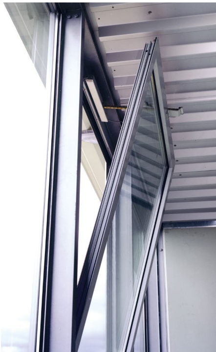
Abbildung 29 Herabstürzen des Fensterflügels da keine Fangvorrichtung vorhanden ist
